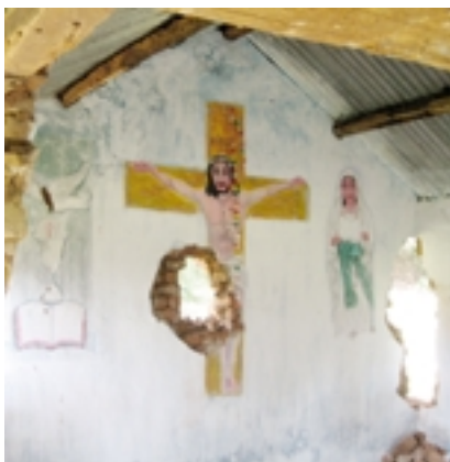
Eine zerstörte Baptistenkirche in Sikko Katta.
